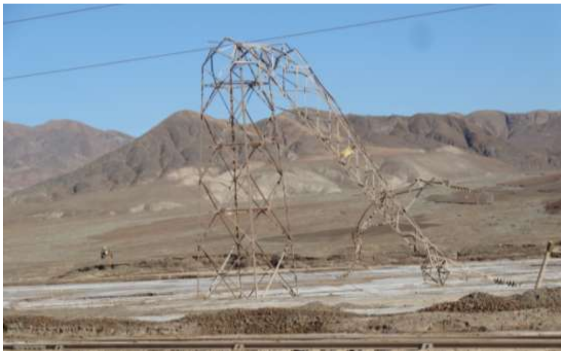
Fig. 6. Colapso de estructura de torre de alta tensión.
