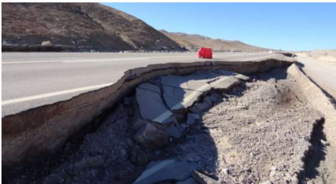
Fig. 8. Se observa erosión ocasionada por los flujos en la ruta C-13.
