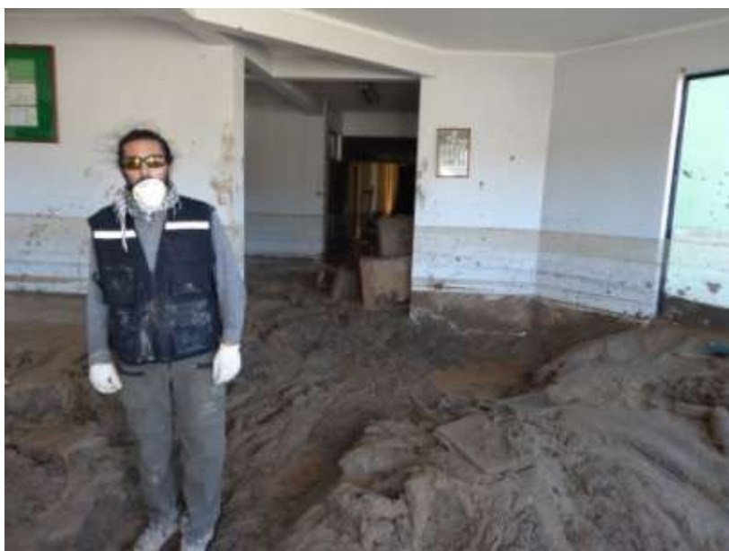
Fig. 3. En recinto de Carabineros, se observa la altura máxima del flujo en la pared y el depósito de barro de hasta 80 cm.
