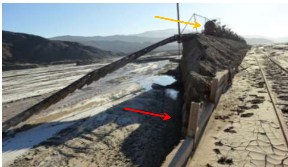
Fig. 4. Flecha naranja indica vagones con ácido sulfúrico. Flecha roja muestra socavamiento de terraplén sobre la cual está construida la línea férrea.
