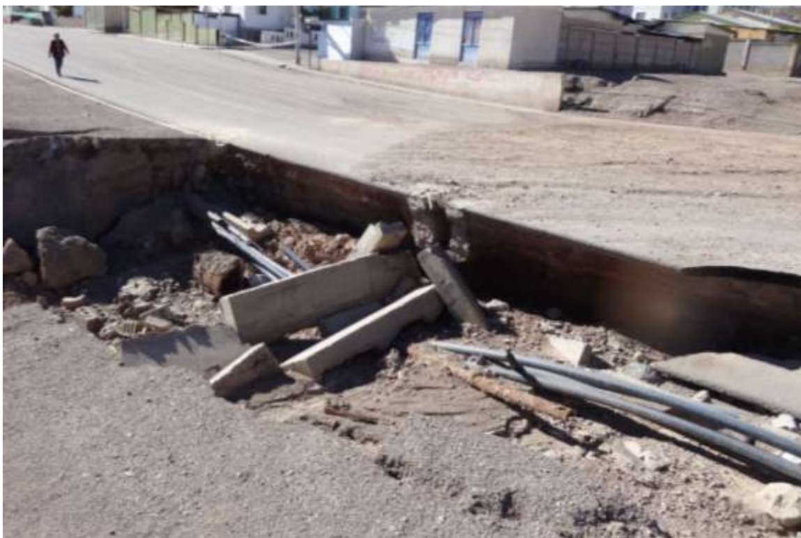
Fig. 10. Se observa socavamiento de la calle O'Higgins por erosión debido al encauzamiento de las lluvias en la ciudad.
