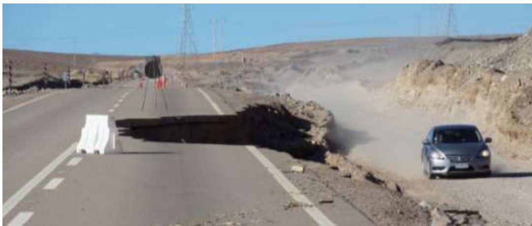
Fig. 9. Ruta C-13 mostrando socavón del sustrato por escorrentía superficial que ocasiona el colapso del camino.
