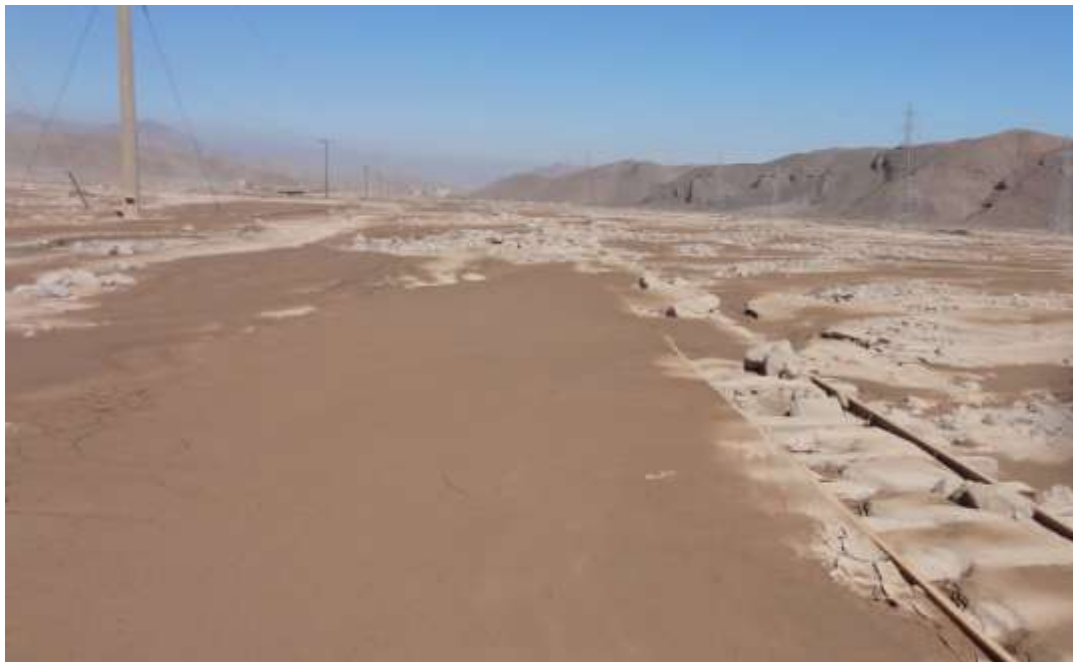
Fig. 12. Quebrada Paipote, se observa flujos de detritos inundando los rieles de la línea férrea, tanto con niveles fino de barro como con bolones decimétricos. La vía férrea no presenta daños estructurales.
