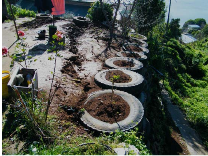
Fig. 2 La parte superior de la “terrazza” del Sr. Pacheco o patio, en el cual, debido a los efectos de las intensas precipitaciones ocurridas, se produjeron varias grietas y hundimientos del relleno arcilloso hacia la pendiente de la ladera, con peligro inminente de colapsar. Se observa la vía peatonal o vereda a la derecha abajo y la fuerte pendiente de la quebrada (hasta 40°).
