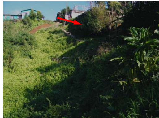
Fig. 4. Vista desde la parte baja de la quebrada hacia el sector inestable (flecha roja) y la precaria vía peatonal de hormigón (Pje. Ernesto Riquelme)
