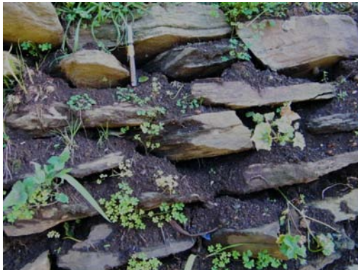
Fig. 3. En los esquistos de la base de la “terrazza” se observa las aberturas producidas por la traslación hacia la quebrada.
